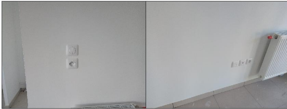
LOGEMENTS DE L'LOT A (+ B03 ET B04) : POSE DES QUINCAILLERIES ET EQUIPEMENTS SANITAIRES EN FINITION
