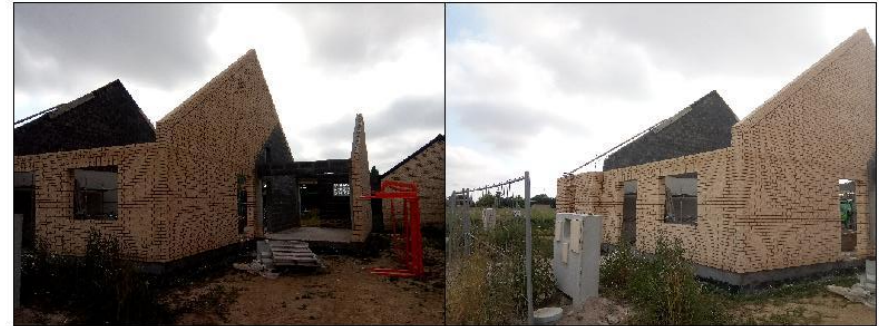
LOGEMENTS B01 ET B02 ELEVATIONS TERMINEES - RESTE UNE POINTE DE PIGNON A DRESSER
