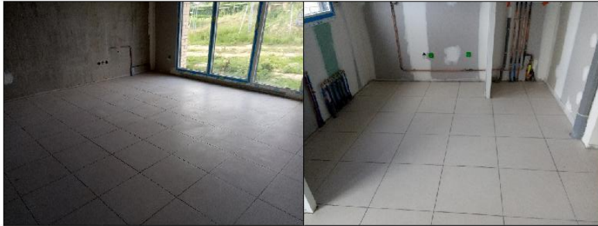
LOGEMENTS B03, B04, A05 ET A06 POSE CARRELAGE TERMINEE (HORS PLINTHES) - POSE PETIT APPAREILLAGE ELECTRIQUE TERMINEE DISTRIBUTION CUIVRE TERMINEE
